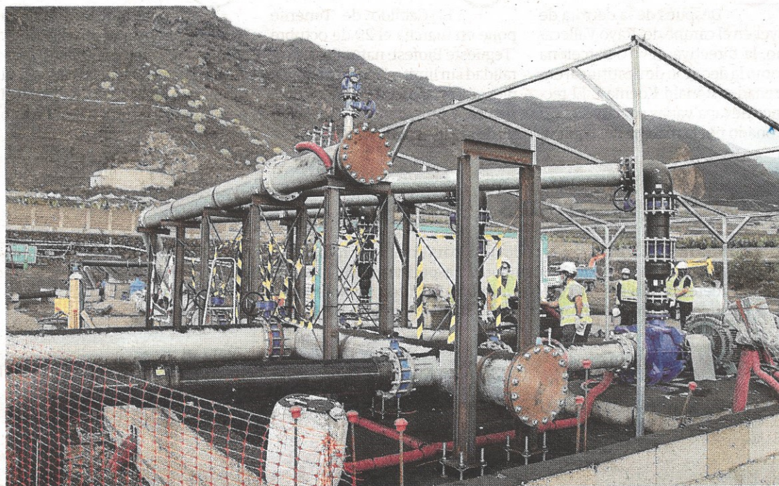
Panorámica de las infraestructuras que se han instalado en el Valle de Aridane. | RAMÓN PÉREZ
