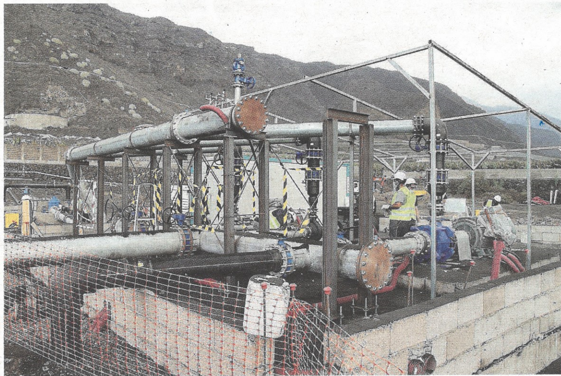
Desaladoras instaladas en Puerto de Naos. | RAMÓN PÉREZ
